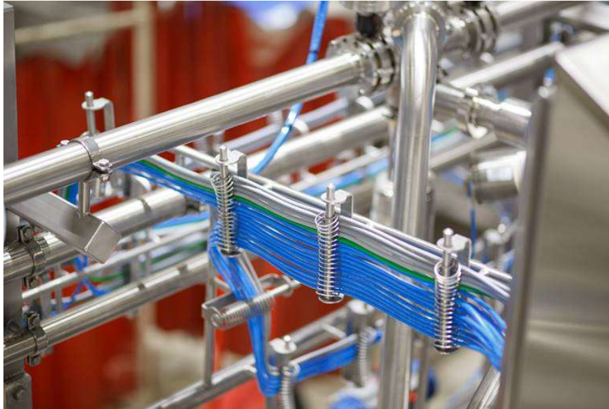
Bekabeling al in engineeringfase in het ontwerp opnemen
